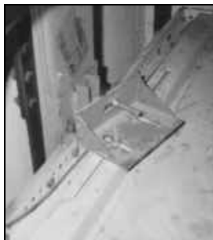
Fig.2.7: Falla de conexión.
