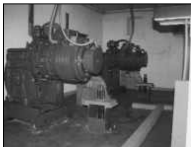
Fig.2.1: Sala de máquinas.
